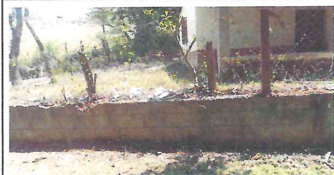
Foto 3: Muro perimetral dañado
