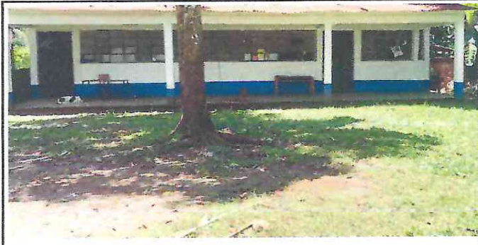
Foto 1: balcones en mal estado
